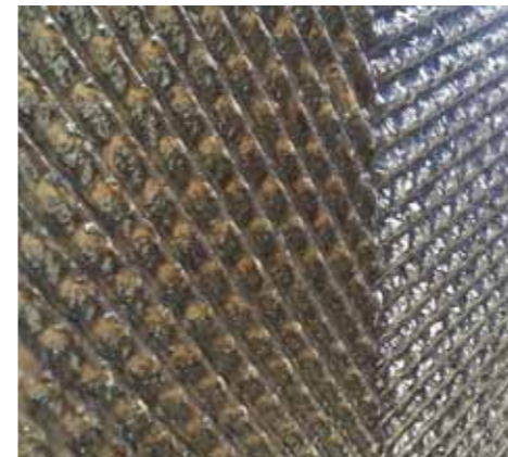
Ohne wirksamem Filter: Verstopfung des Wärmetauschers durch Ablagerungen
