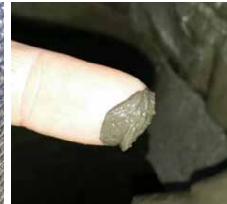
Schlamm aus einer neu installierten Anlage
